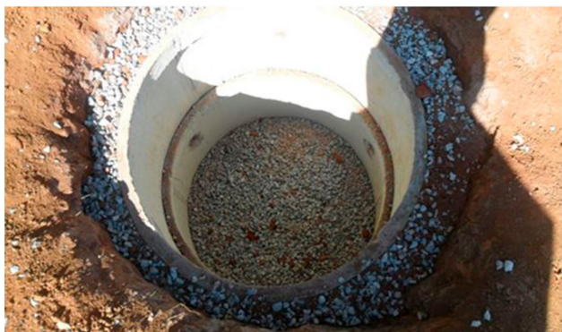
Fonte: Google - Simidouro (dreno)
